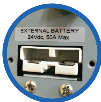
Entrada banco de baterías externas
